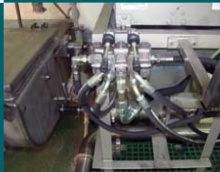
Distribuidor del motor hidráulico.
