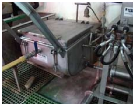
Evacuador de residuos al mar.
