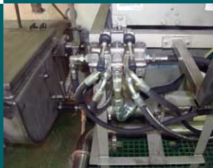
Distribuidor del motor hidráulico.
